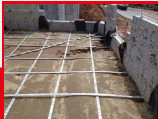
Figura 4 - Erosão no aterro, durante a construção da contenção em terra armada, o que desaprumou as escamas.
