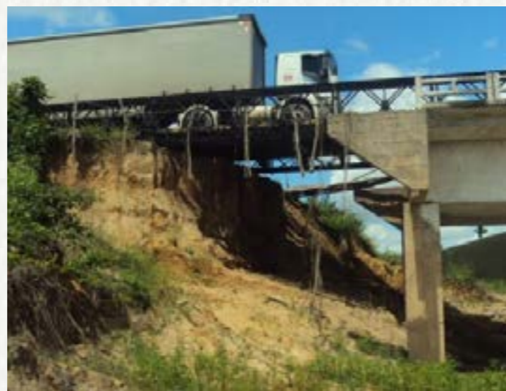
Figura 9 - Destruição de aterro de acesso de ponte sem encontros e com o restabelecimento temporário do tráfego através de ponte provisória.
