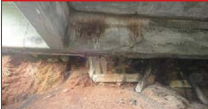
Figura 6 - Fuga do material do talude sob as cortinas, nas extremidades dos balanços, com alturas insuficientes, desestabilizando o aterro de acesso e o pavimento.
