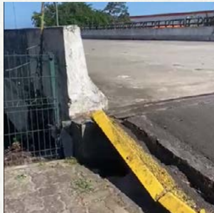
Figura 3 - Desnível acentuado entre a plataforma da ponte e a laje de transição, fraturando a mureta lateral, abrindo a junta de dilatação, expondo-a a água da chuva e erosão no aterro abaixo.
