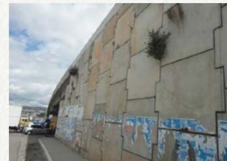
Figura 7 - Grande extensão de uma contenção de aterro de um viaduto urbano com terra armada, gerando a sensação de confinamento aos moradores das vias marginais. Observa-se também o surgimento de vegetação e outras patologias decorrentes de infiltrações e de falhas na fixação das escamas de concreto.
