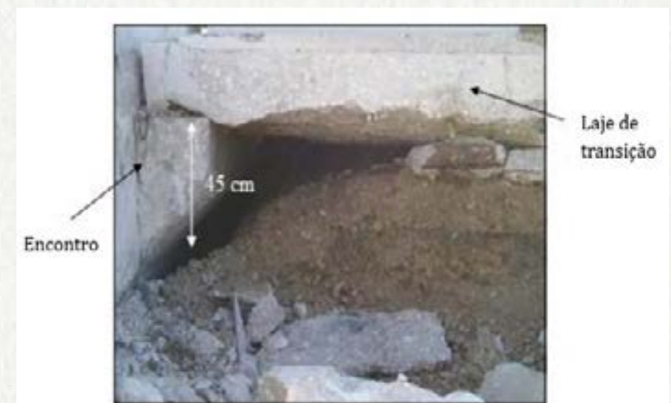
Figura 3 - Perda de solo do aterro sob a laje de transição.
