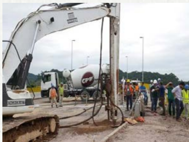
Figura 4 - Nesta ponte, com processo de recalque crescente, e conseqüente ressalto, teve intervenção com melhoramento do solo com geoenrijecimento, paralizzando sua evolução.
