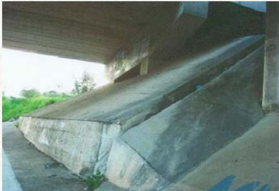
Figura 2 - Proteção do talude do aterro de acesso de ponte com encontro em balanço, com uma camada de concreto e um dissipador de energia para a descida das águas.
