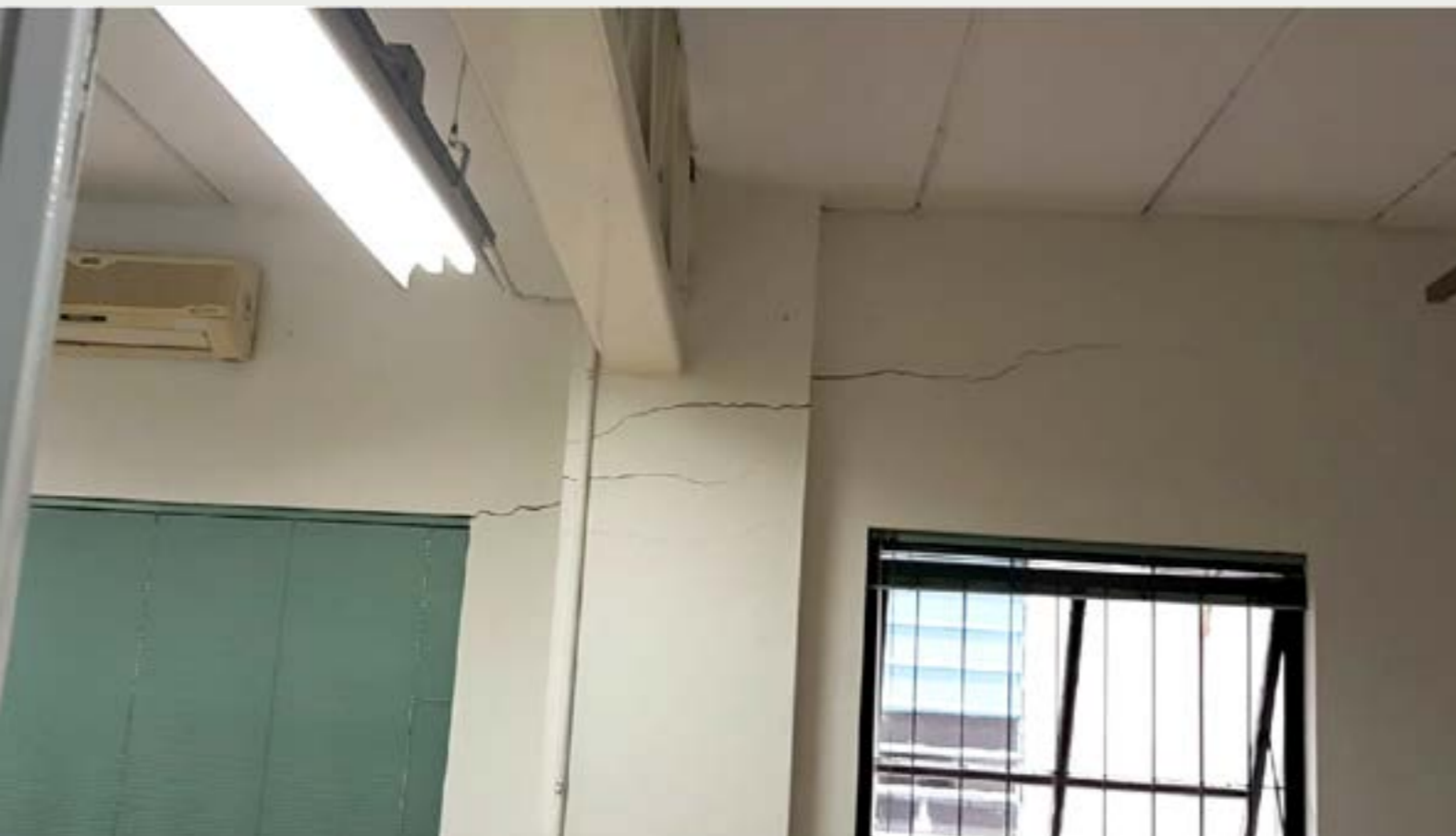
Figura 6 - O tipo da edificação, com seus detalhes construtivos estabelecem quando se apresentam problemas com a presença de solos argilosos moles, trincas e fraturas, nas paredes, consoante com seus elementos de fundação. Neste caso, trata-se de uma construção muito antiga, sobre sapata corrida assentada em camada de solo mole.
