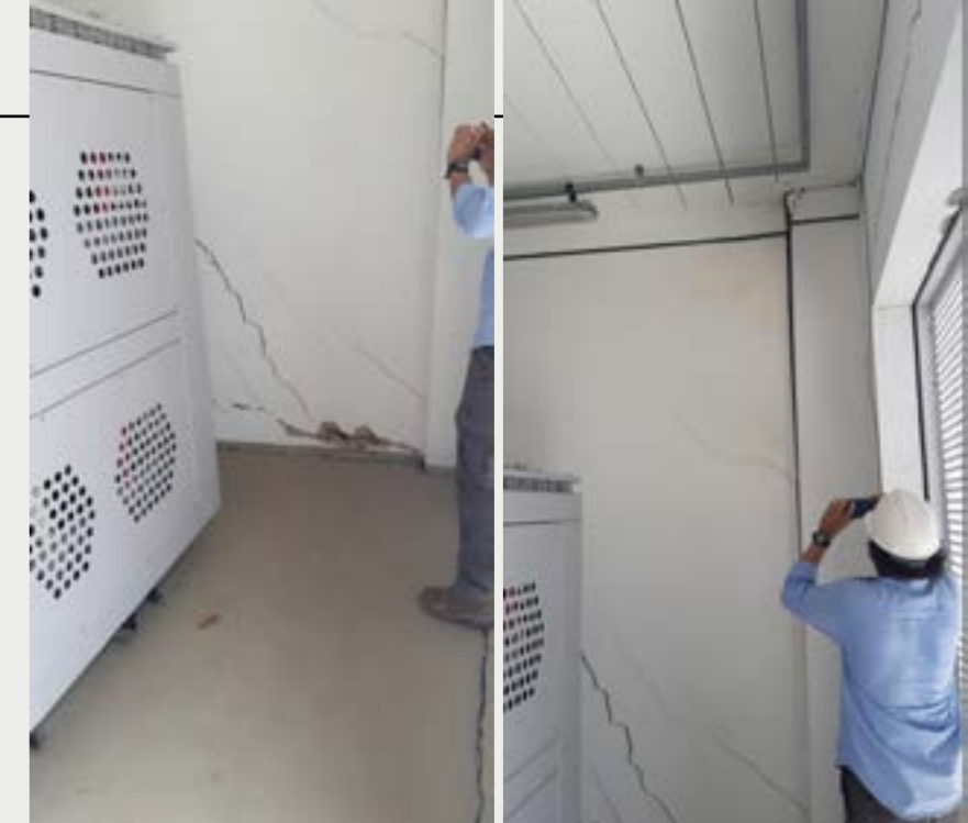
Figura 8 - Trincas em paredes de um empreendimento logístico. Fundação direta sobre sole.
