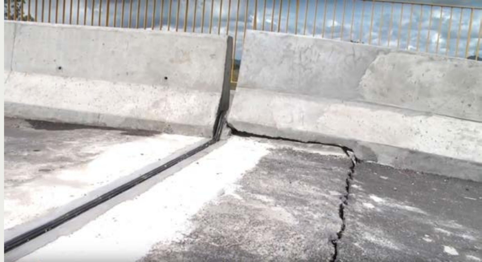
Figura 3 - Esta ponte, com poucos meses de construída apresentou sério processo de recalque a partir da laje de aproximação.
