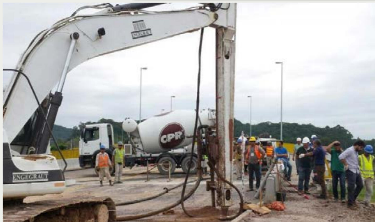
Figura 6 - A intervenção nesta ponte, recém inaugurada, demorou apenas dois dias, suficiente para reduzir drasticamente o processo de recalque, com formação de ressalto, no pavimento do aterro de encontro.
