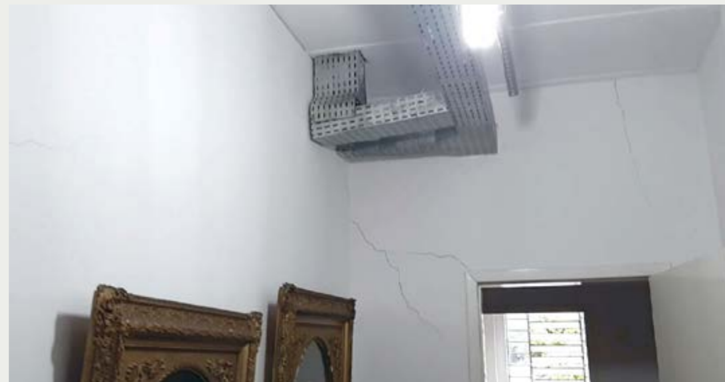
Figura 10 - A disseminação das trincas nas paredes de uma antiga edificação. O sistema construtivo de cerca de 100 anos atrás, com grossas alvenarias e sapatas escalonadas corridas, impõe característica diferenciada de trincas nas paredes, motivado pela presença de solos moles em seu solo de fundação.
