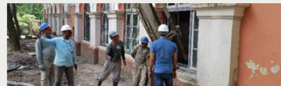
Figura 9 - O processo de Georrijecimento adentrando na edificação para melhoramento do solo mole sob os elementos de fundação direta de uma antiga edificação com recalques diferenciais.
