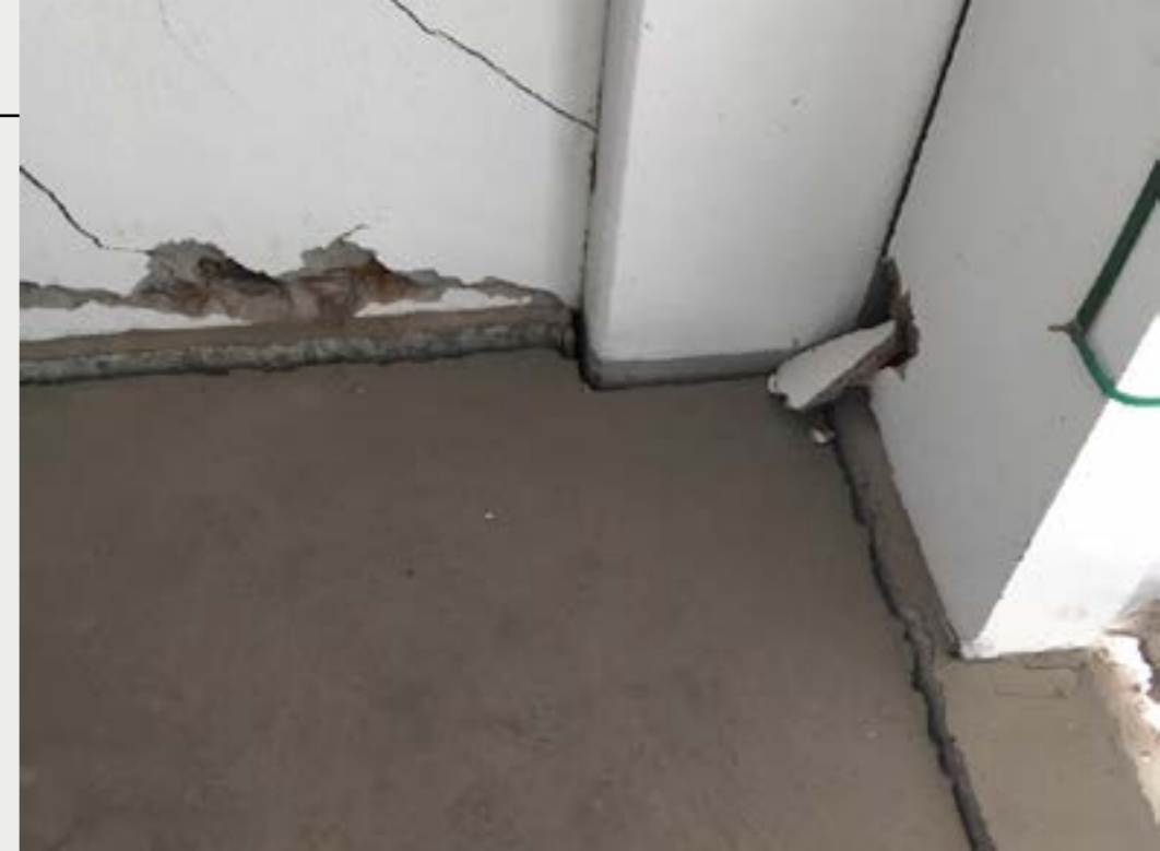
Figura 4 - Neste canto de uma edificação, verifica-se o comprometimento de sua fundação, devido a presença de solos moles.
