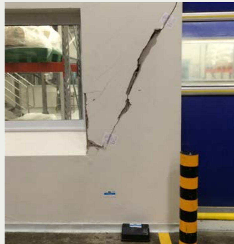
Figura 16 - Trinca a 45° em parede.
