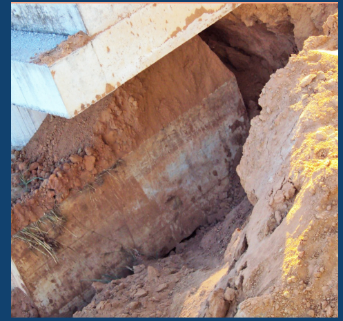
A movimentação lateral da profunda massa de solo mole, destruiu estacas e toda a estrutura superior, via efeito Tschebotarioff.
