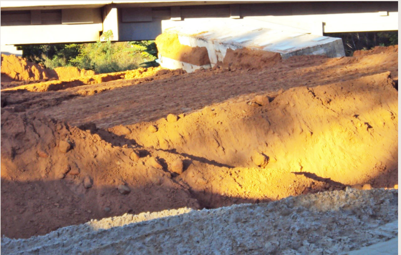
Rutura do solo de fundação, após pré-carregamento, devido ao peso de aterros levantados de maneira assimétrica, causando o efeito Tschebotarioff em estruturas da nova ponte
