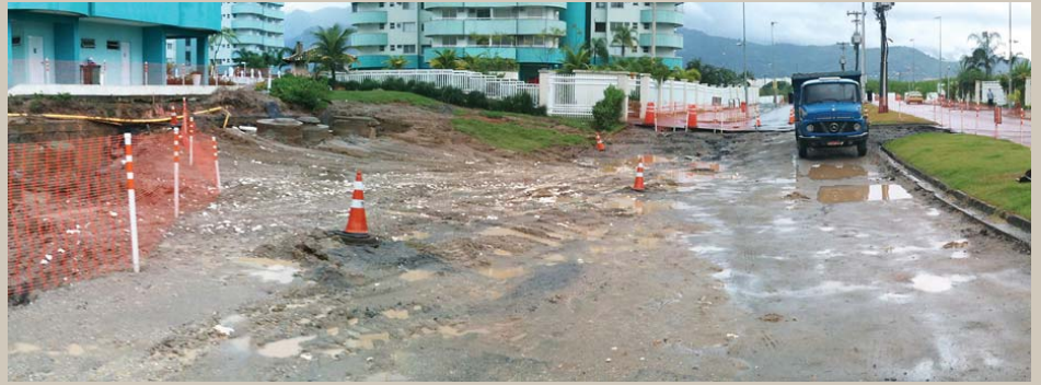
Visão panorâmica das edificações da Vila do Pan (R.J), apresentando recalques e colapso no pavimento. Presença de depósitos de solos moles orgânicos.
