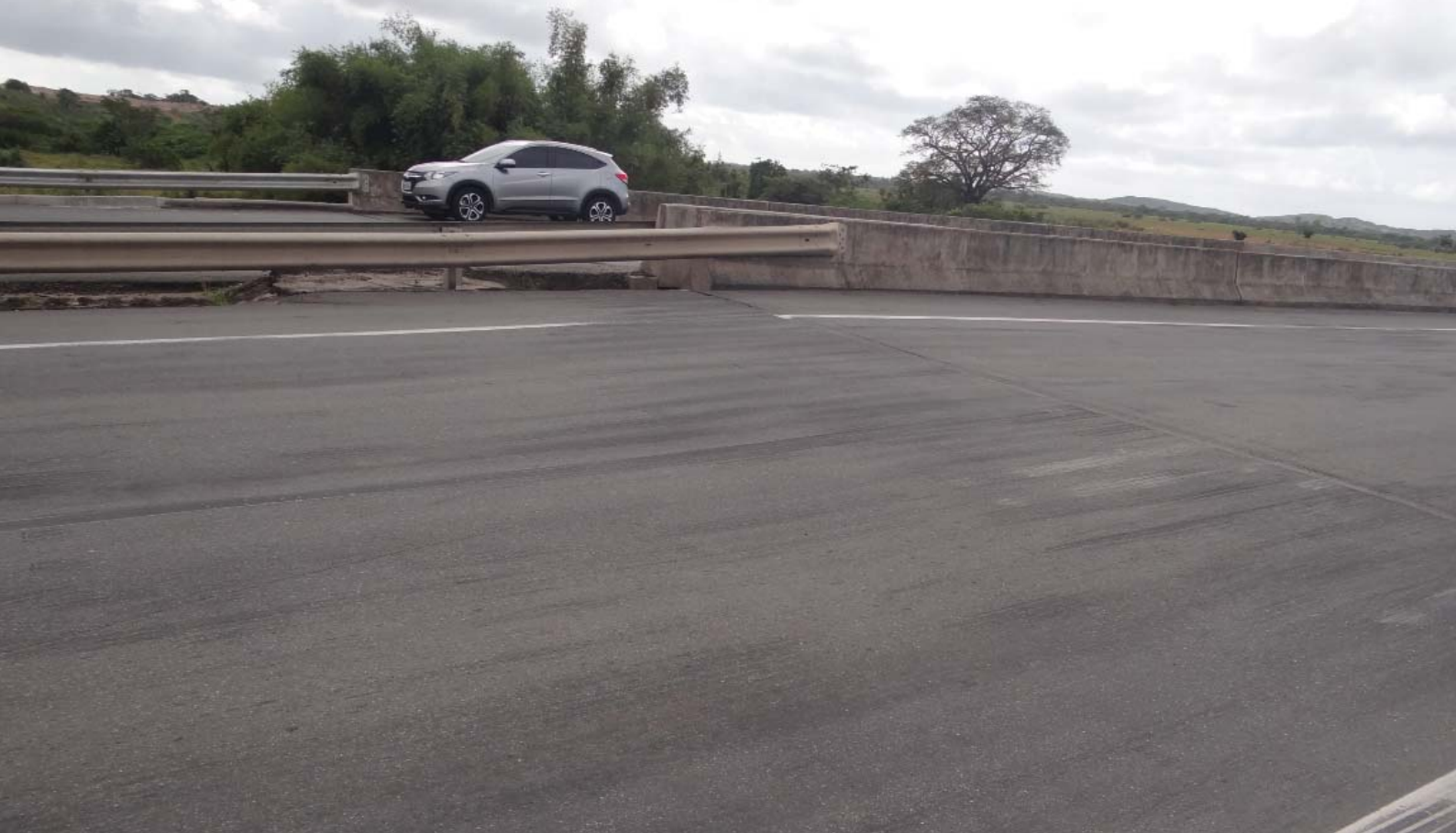
Figura 7 - Além de ondulações e toda a sorte de desníveis em nosas rodovias, ressaltos nos encontros de pontes caracterizam-as como inseguras e de baixa qualidade.
