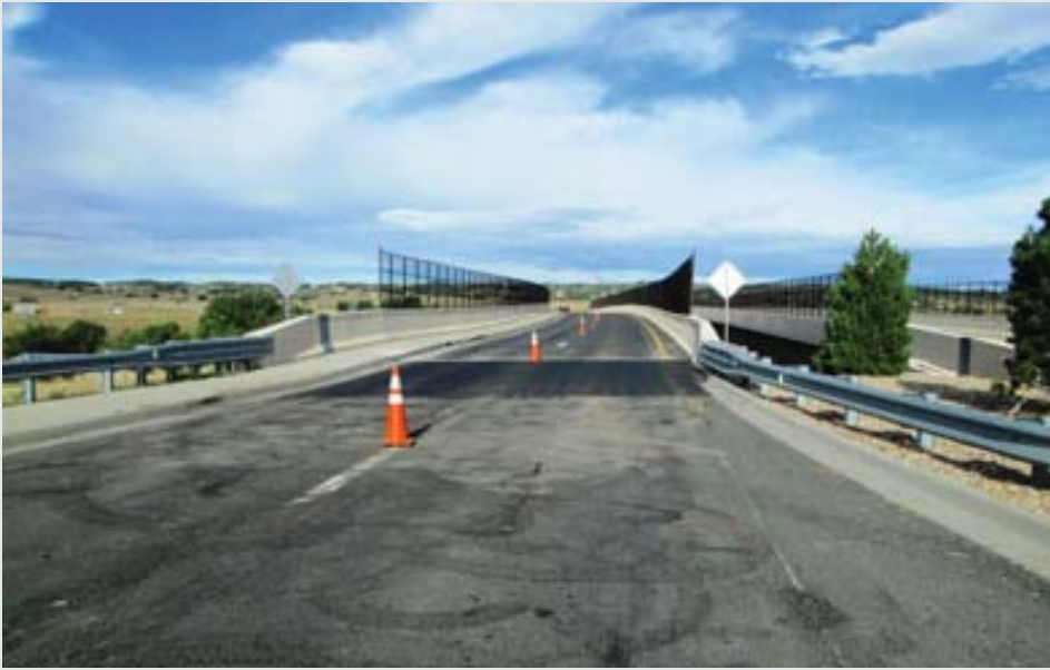
Figura 4 - A correção do ressalto com asfalto só piora o problema, comprometendo as estacas.
