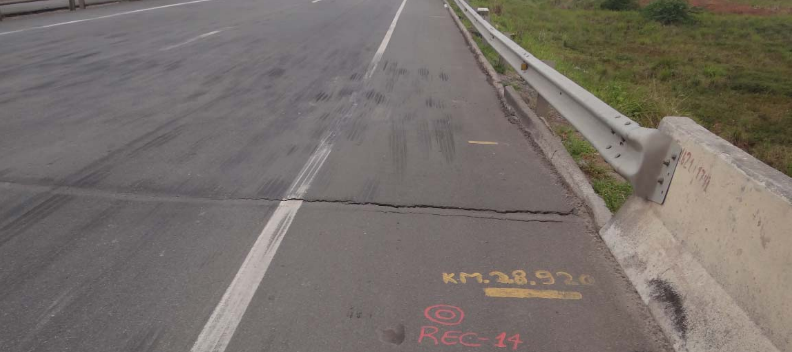
Figura 5 - É comum presenciarmos ressaltos em nossos encontros de ponte.
