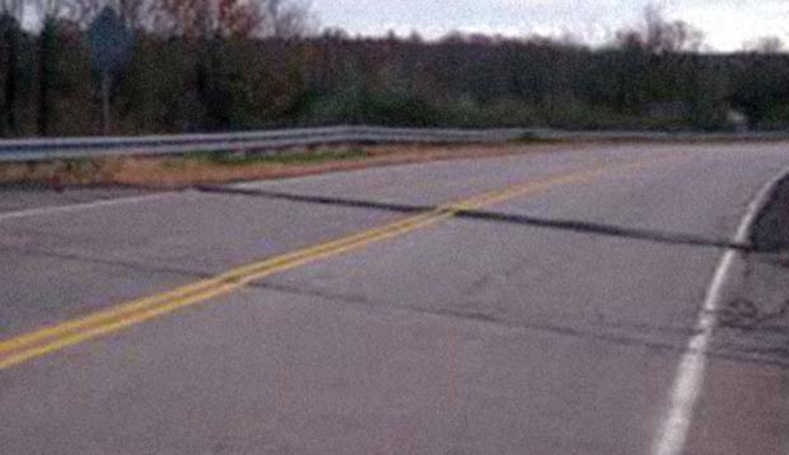
Figura 2 - O problema dos encontros de pontes e viadutos: o ressalto devido ao recalque do aterro, provocado pela presença de solo mole.
