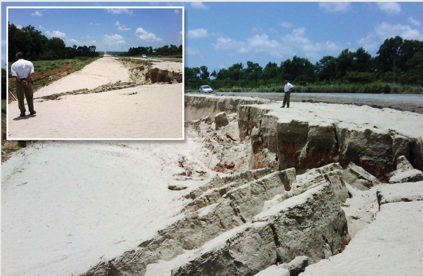
Figura 14 - Fotos da primeira ruptura, devido ao aterro levantado, sem que houvesse qualquer trabalho de melhoramento do profundo depósito de solo mole no local, a 50m da ponte.
