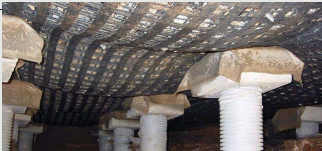
Figura 5 - Aterro estaqueado sobre plataforma de transferência de cargas: grandes recalques sob a plataforma, impondo enormes tensões na geogrelha e nas cabeças das estacas.
