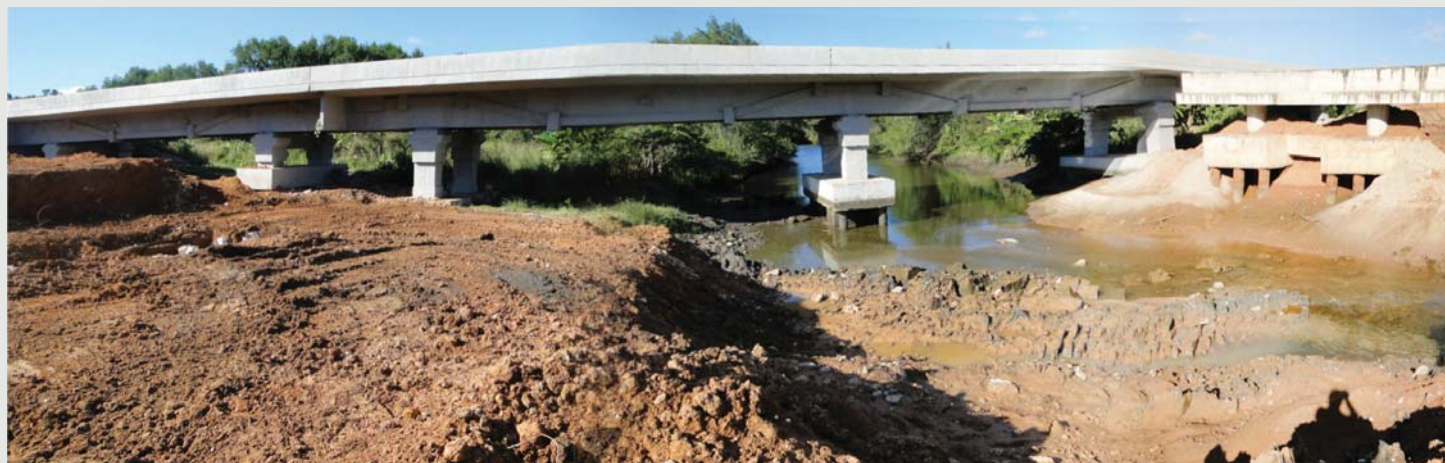
Figura 16 - Nesta foto, no lado esquerdo, a remoção do aterro após a 2ª ruptura, ficando evidente o corte efetuado na cabeça das estacas. No outro lado do rio, nota-se, comparativamente, o que foi removido em consequência da segunda ruptura.
