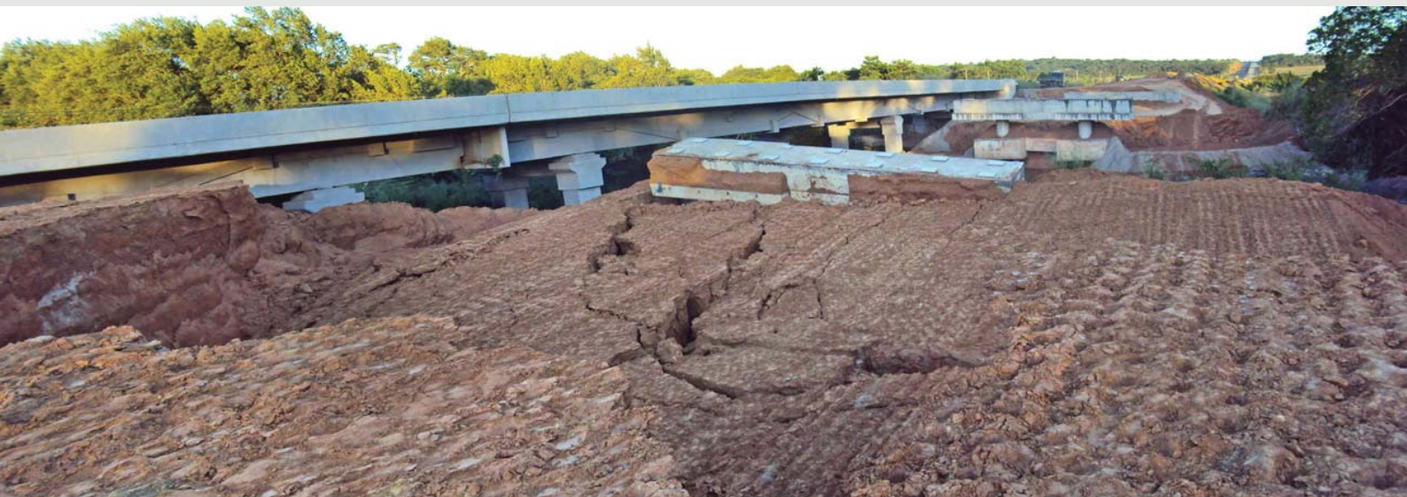
Figura 15 - A segunda ruptura ocorreu em direção ao rio, destruindo a nova estrutura da ponte, interrompendo seu fluxo.
