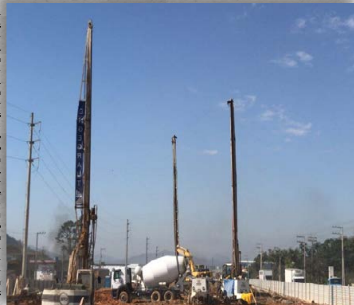
Figura 2 - Obra de ampliação estradal com geoenrijecimento do solo mole no sul do país
