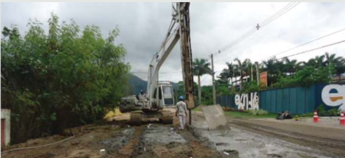
Figura 14 - O Geoenrijecimento de depósitos de solo mole foram essenciais para a construção do bairro Pontal Oceânico no Rio de Janeiro.
