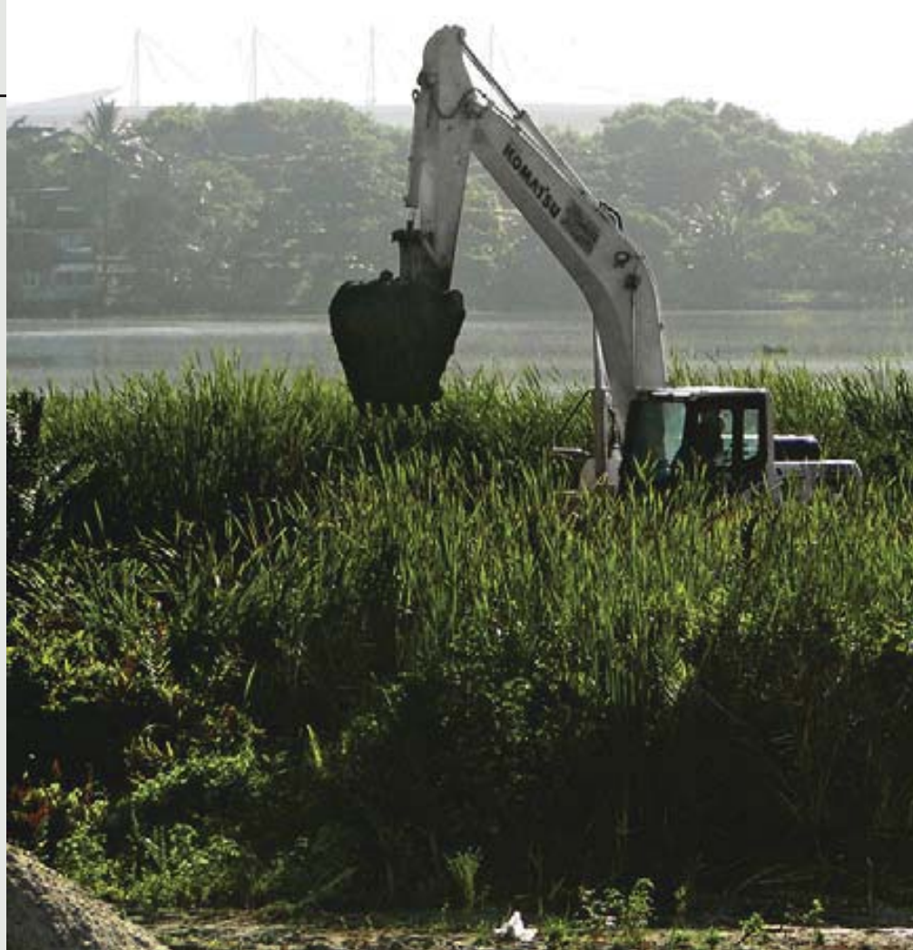
Figura 14 - Corte de vegetação pertinente à Lagoa de Jacarepaguá. Posteriormente foi feito o geoenrijecimento para a construção da Cidade do Rock, no Rio de Janeiro.
