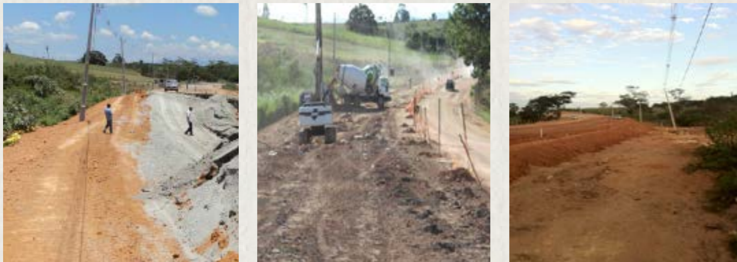
Figura 3: Antes, durante e depois com a construção de novo aterro, nesta ampliação estradal, no município de Quissamá, RJ.
