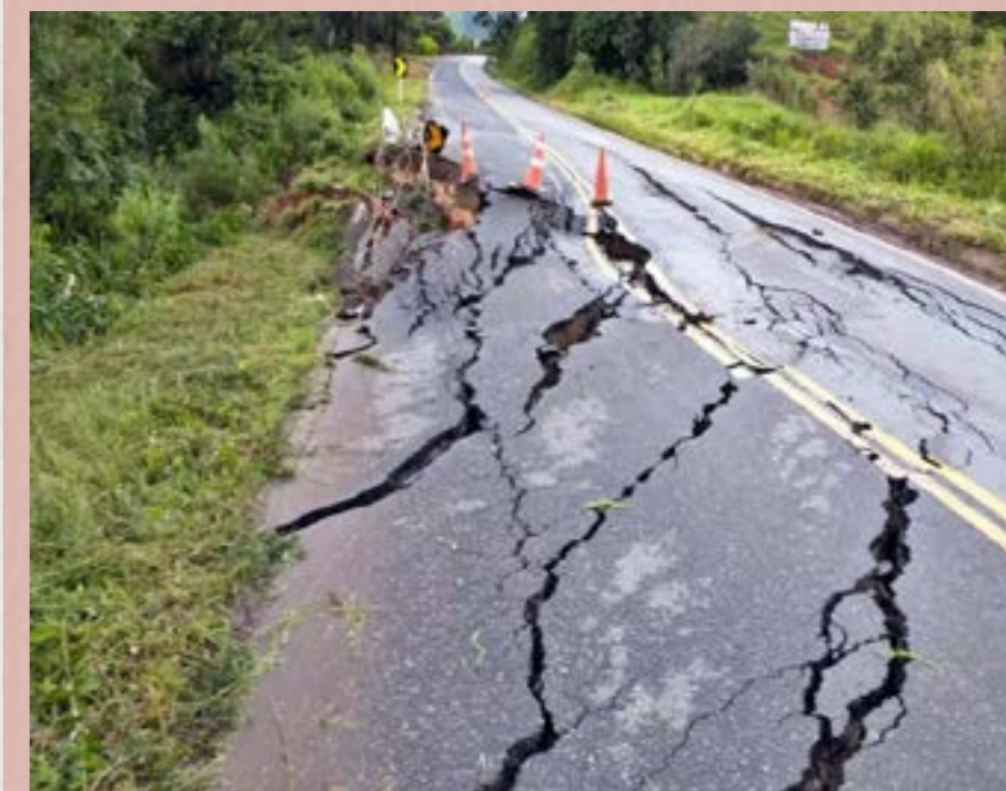
Figura 2: A heterogeneidade do solo de fundação causou esta rutura. Dai a necessidade de homogeneizá-lo, ao longo do percurso, com melhoramento do solo.
