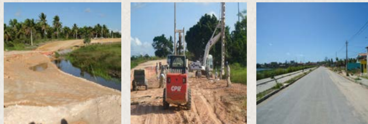
Figura 5: A tentativa de elevação do novo aterro, ocasionou o afundamento de extenso trecho estradal, na PE-051. Fotos do antes, durante e depois, com a estrada elevada e ampliada, devido ao melhoramento do solo.
