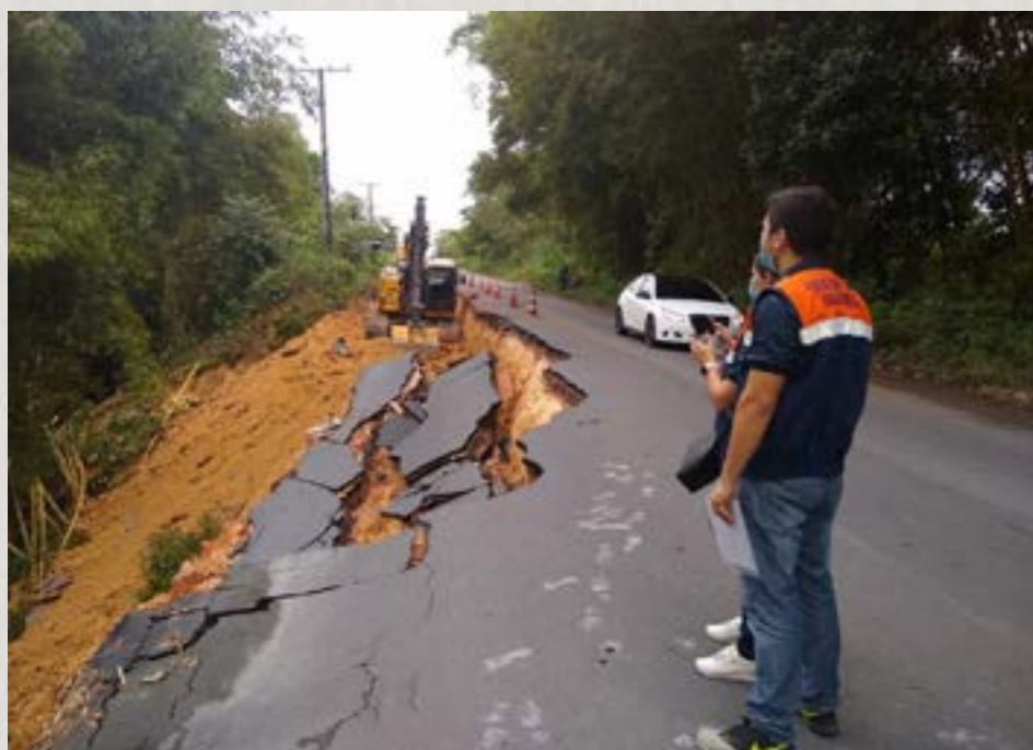
Rutura do aterro estradal.
