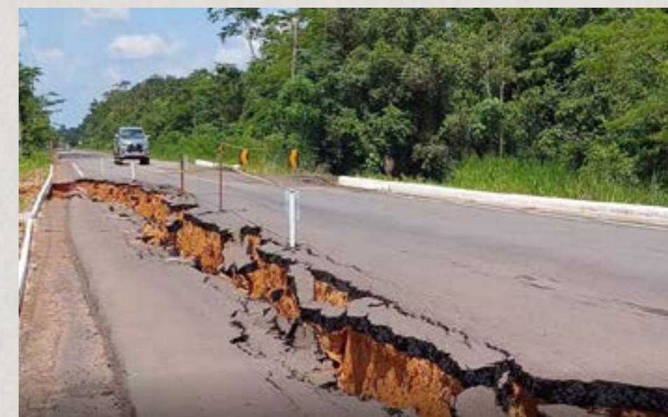
Rutura do aterro estradal.
