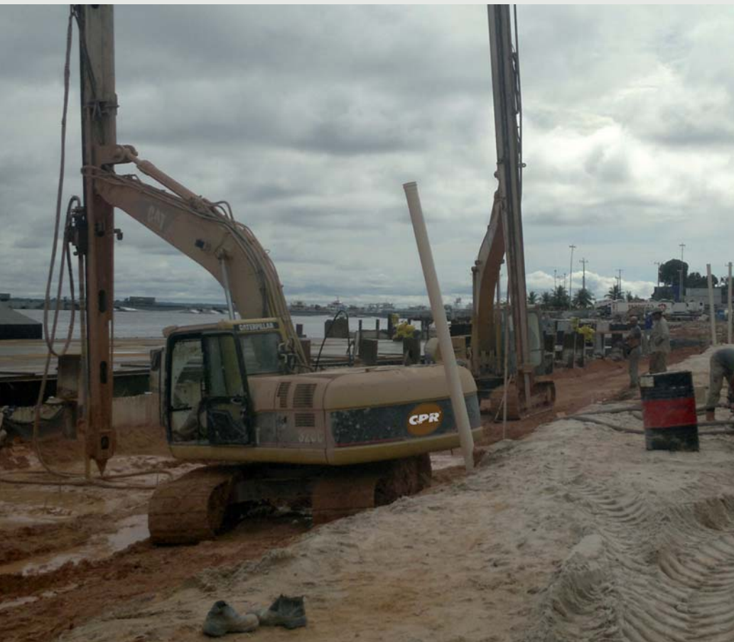
Figura 10 - Georrijecimento do solo, às margens do Rio Negro, na área portuária de Manaus. Este Rio tem seu processo de cheia e vazante, num total de 15m de altura em apenas 6 meses, o que desestabiliza os taludes da área portuária de Manaus e de toda a Amazônia, causando o fenômeno das terras caídas.
