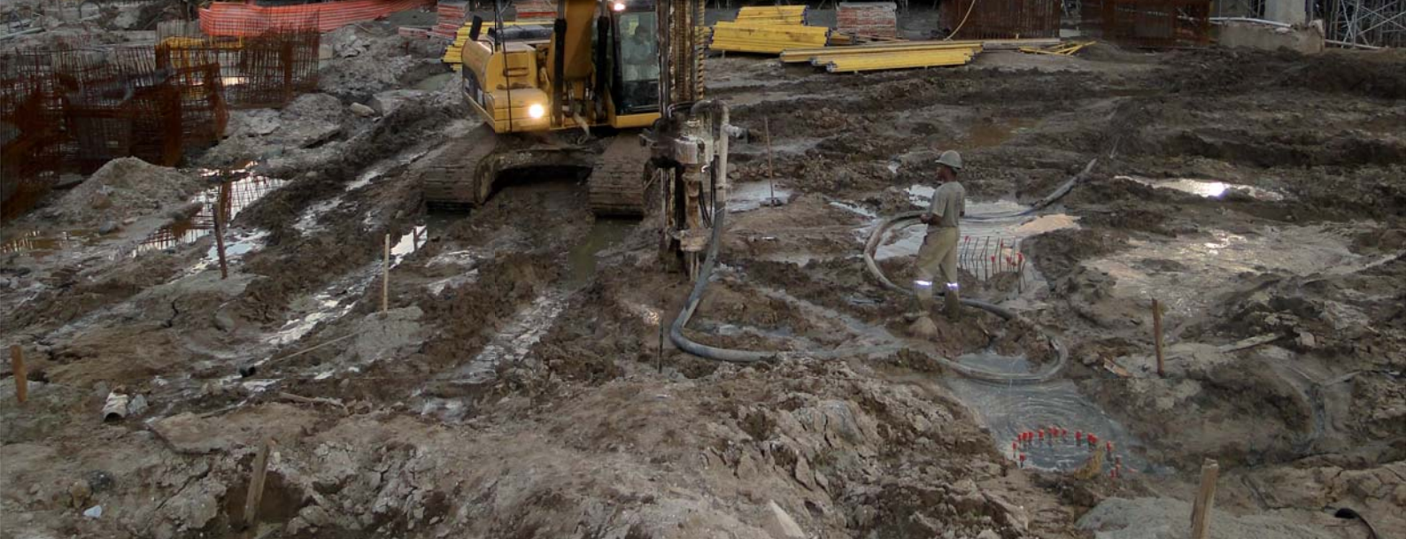
Figura 1 - A movimentação de solo mole devido à escavação, nesta obra, provocou deslocamento nas estacas metálicas, previamente cravadas. Necessidade do Geoenrijecimento para dar continuidade à obra.
