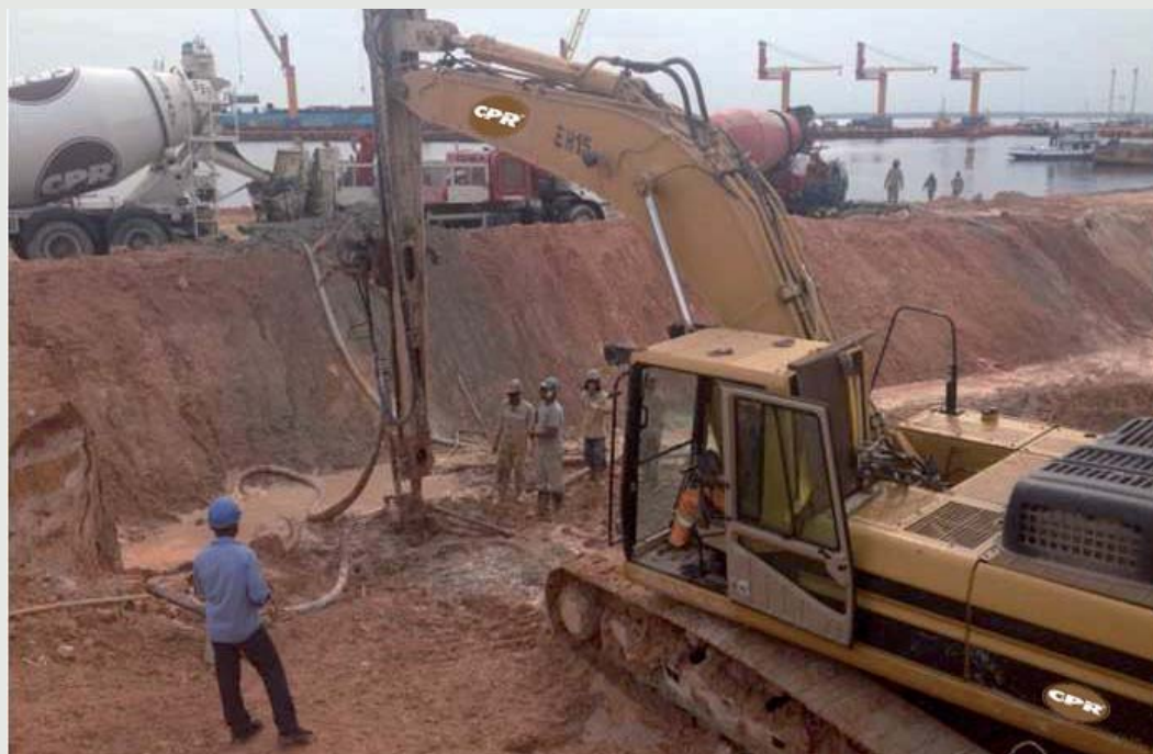
Figura 8 - Melhoramento do solo, com Geoenrijecimento, em área portuária fluvial no Vale do Itajaí, SC.
