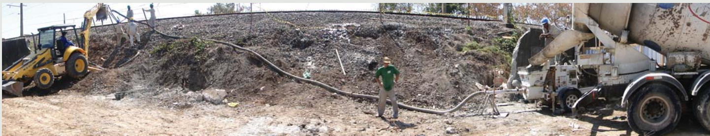
Figura 5 - A necessidade da execução de travessias, com Tunnel Liner, sob a ferrovia Central do Brasil, no Rio de Janeiro, exigiu o melhoramento do solo com Geoenrijecimento, utilizando Compaction Grouting.
