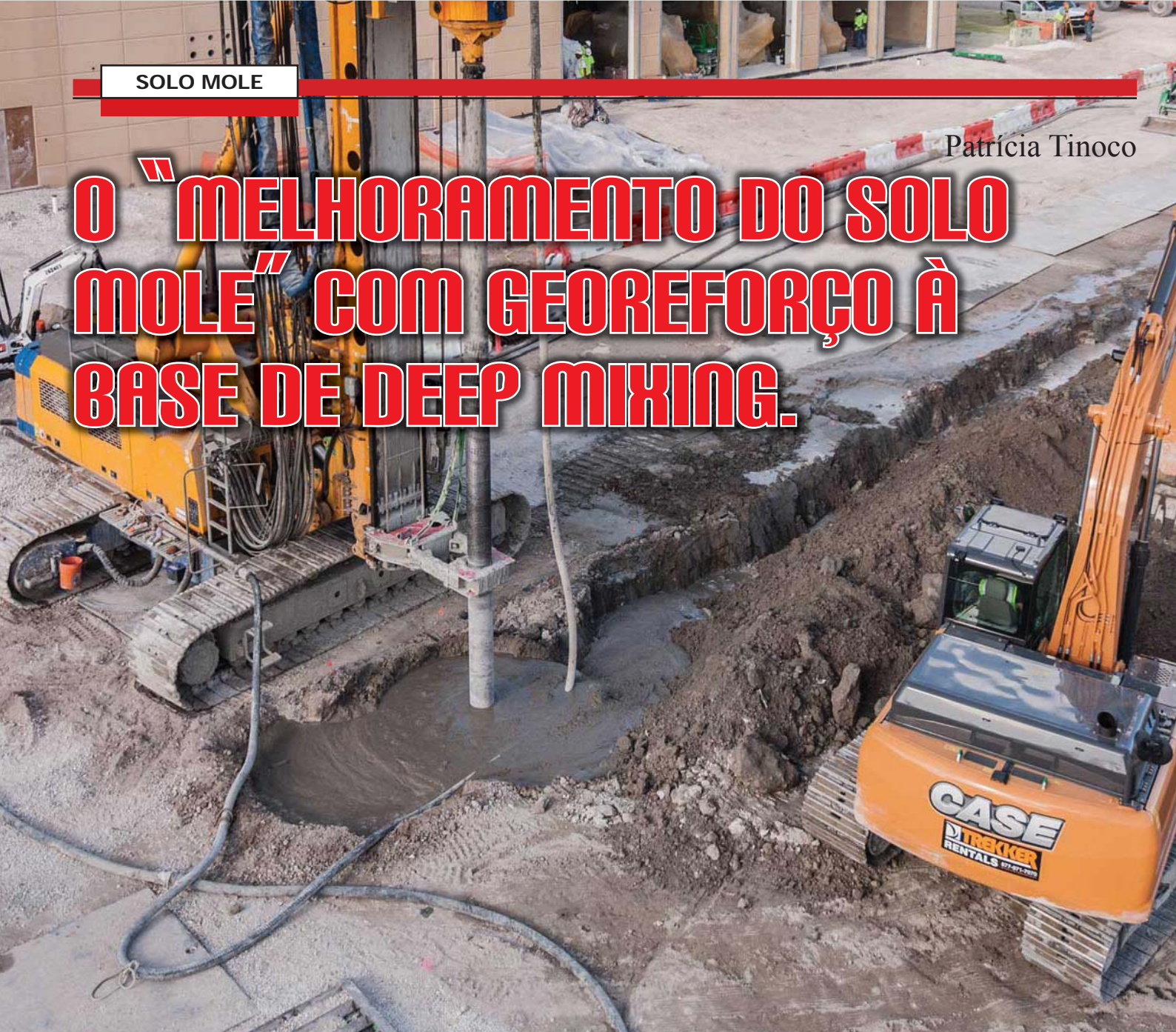
Figura 1 - O deep soil mixing. Promove-se a formação de colunas de solo cimento, misturando-se o cimento ao solo. No espaço entre colunas permanece o solo mole.
