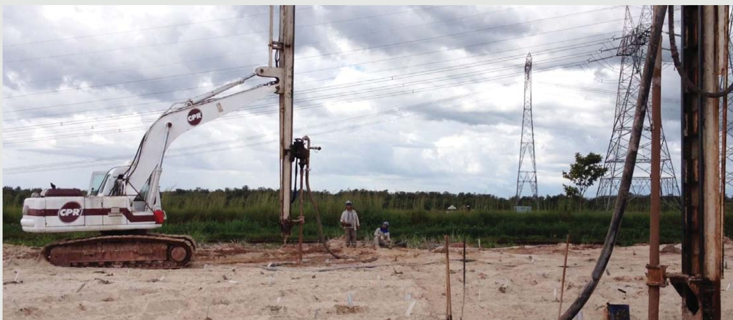
Figura 3 - Próximo ao município de Bacabeiras, foi feito o melhoramento do solo com Geoenrijecimento utilizando o CPR Grouting, de modo a possibilitar a ampliação rodoviária da BR-135 e o remanejamento da ferrovia da CFN, considerando-se a proximidade da antiga ferrovia de Carajás.
