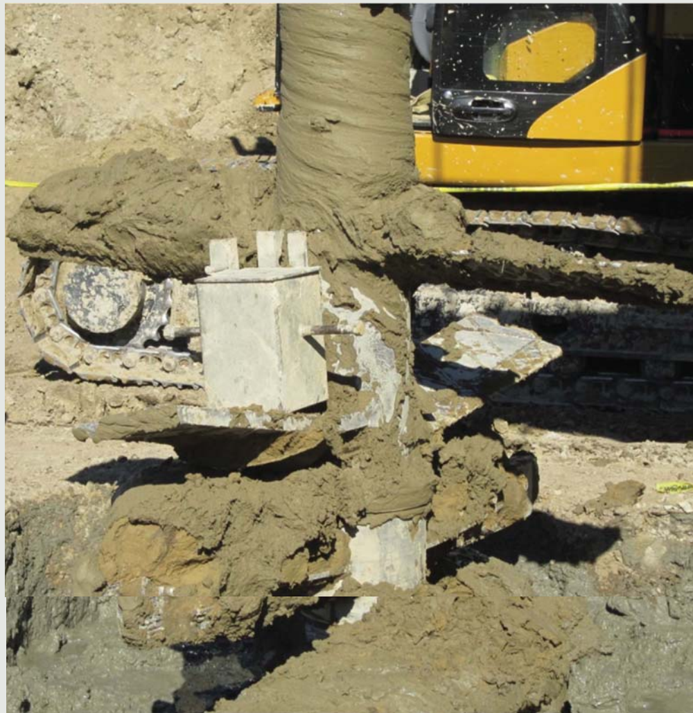
Figura 10 - A lança com o trado que promove a inserção de cimento e promove a mistura com o solo.
