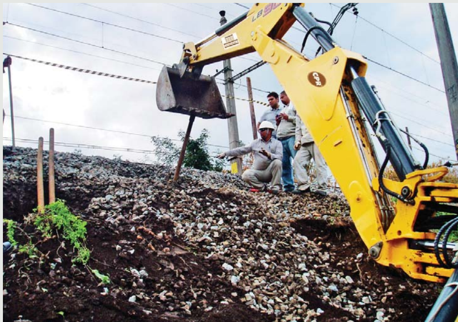
Figura 4 - A necessidade da execução de travessias, com Tunnel Liner, sob a ferrovia Central do Brasil, no Rio de Janeiro, exigiu o melhoramento do solo com Geoenrijecimento, utilizando Compaction Grouting.
