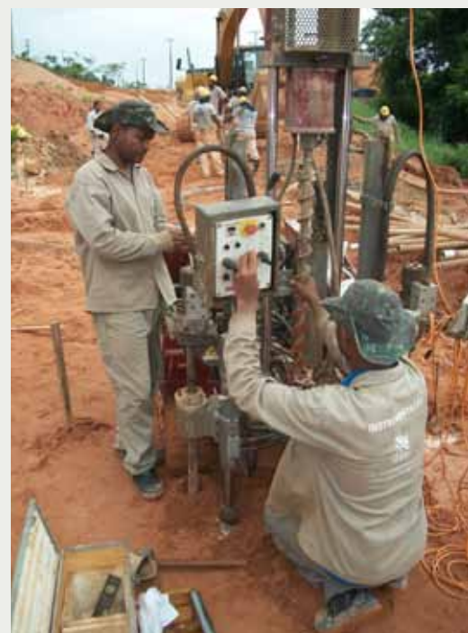
Figura 4 - Execução de ensaio CPT-U em solo geoenrijecido em Salvador, BA, sem sucesso, ou sem obtenção de critério de resistência. A execução, posterior, de ensaio Pressiométrico certificou condição extremamente resistente.
