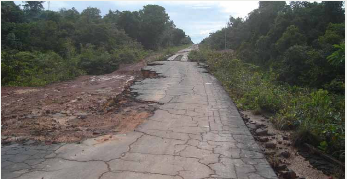
Figura 6 - Estrada construída, sem infraestrutura mínima necessária, que se perde rapidamente frente ao clima e a geologia local.
