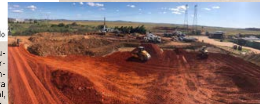
Figura 5 - Grandes áreas, com presença de solos moles, estão sendo urbanizadas.
