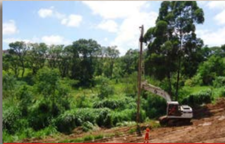
Figura 3 - Extensas áreas estão sendo adequadas para fins logísticos, comerciais e residenciais. Em comum o solo mole.
