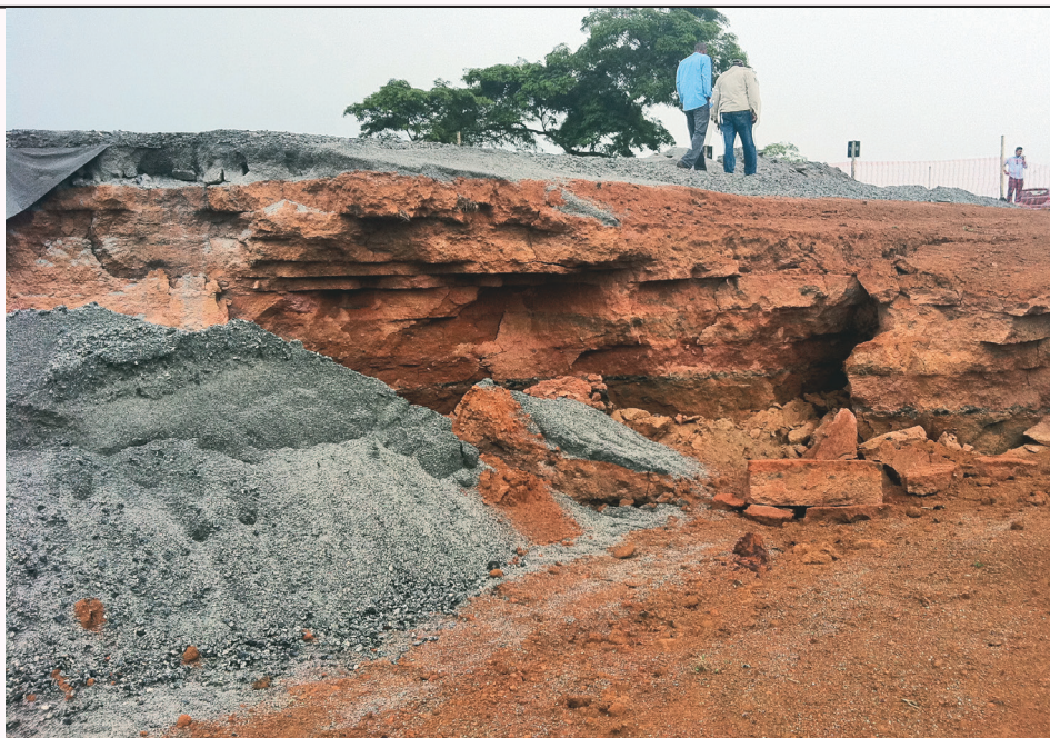
Figura 2: Ruptura de aterro estradal, lançado sem melhoramento prévio do solo mole suporte em ampliação de rodovia.
