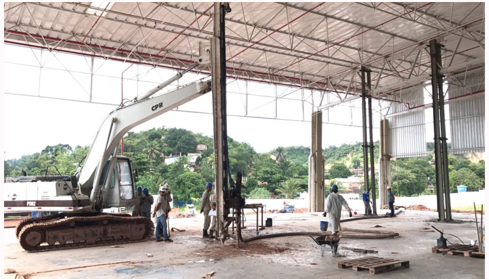
Figura 4: Área logística, com severo processo de recalque, devido a espesso aterro lançado sobre solo mole sem qualquer melhoramento. O geonrijecimento está sendo executado dentro das instalações.
