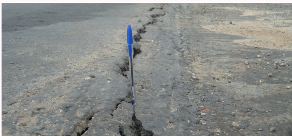
Figura 3: Trincas longitudinais, ao longo da via, em uma rodovia ampliada sem execução do escalonamento no talude original
