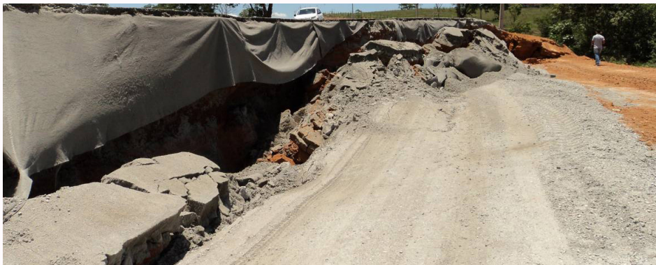
Figura 5: Grande ruptura do solo, durante a elevação de aterro para ampliação rodoviária, sem que houvesse melhoramento do solo.
